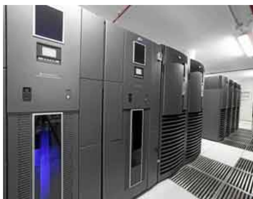
El supercomputador FinisTerraes, en el CESGA.
