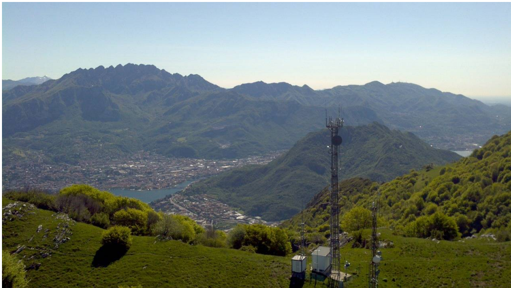
Antena de telecomunicaciones en una zona rural. / Pixabay
